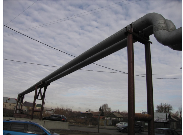
Надземный теплопровод МУП «ЧКТС», 2009 год
